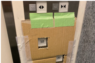
復旧当初、稼働台数が限られていたため 停止階を制限して運行されたエレベーター
